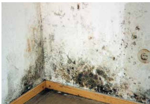
Formazione di muffa al piede della muratura dell'edificio non isolato
